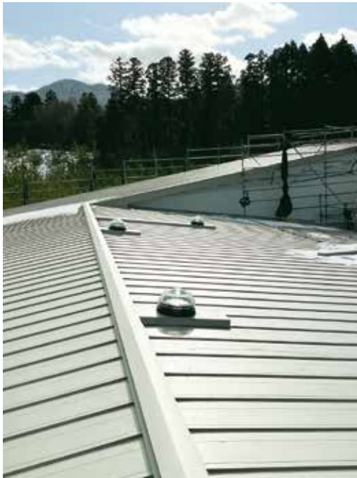
▲施設屋根部分/ガルバリウム鋼板の立平葺き屋根にスカイライトチューブを3台設置
